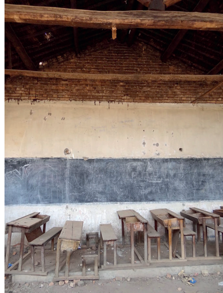
Afb. 3: Verbrand klaslokaal in het Kabgayi ziekenhuis, Rwanda. Bron: Adam Jones, Ph.D., Wikimedia Commons.
